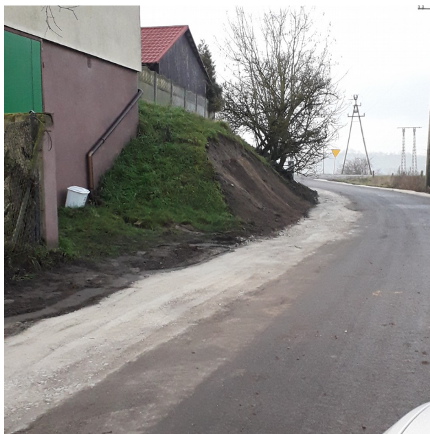
Modernizacja drogi gminnej G129331P w Osieku nad Notecią – wykonanie obustronnego poszerzenia z kruszywa łamanego na odcinku 500 m
